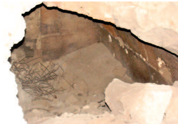
Сводчатая комната под алтарной апсидой собора, разрушенная кладоискателями (фото епископа С. Чулджяна, 2011 г.)
